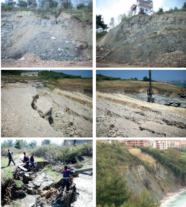
Şekil 7. Karadeniz sahil yolu yapımı aşamasında meydana gelen heyelanlara ait görüntüler. Figure 7. Landslides occurred during the construction of the Blacksea coastal road.
